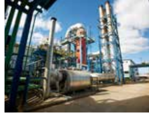
Mali Akaryakıt Santrali
